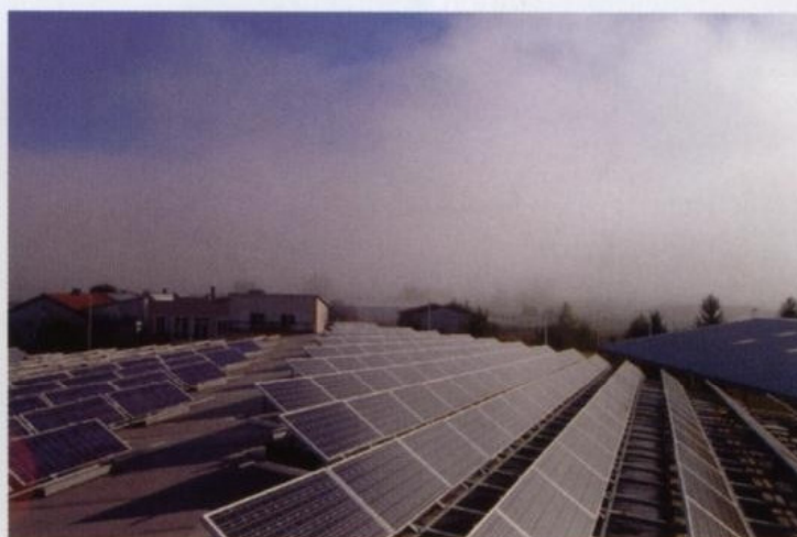
Teilaufnahme 140 kW aufgeständert
