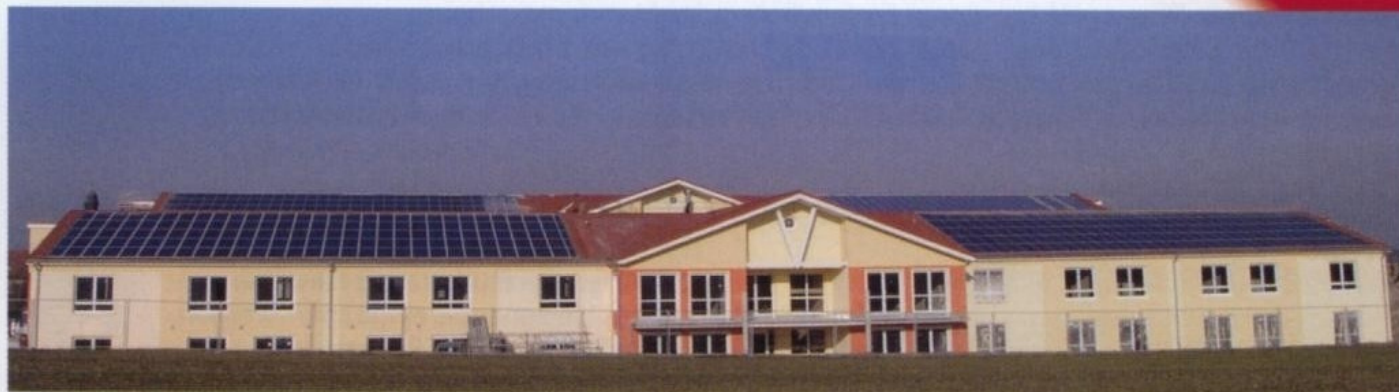
130 kW Netzparallelanlage dachintegriert mit SUNpower Roof®
